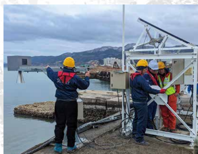
津波観測装置の設置 (輪島港)
