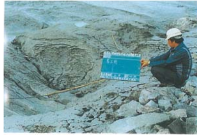
写真-4 南護岸（土砂の吸い出し穴）
