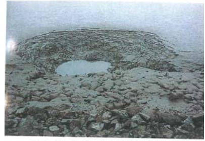
写真-7 土のう投入箇所周辺に発生した穴
