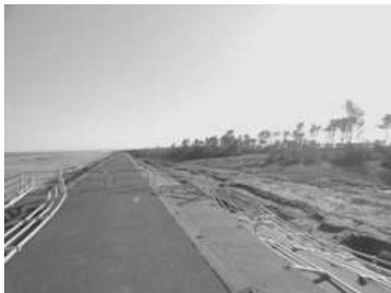
写真-5.3.8.11 護岸（2011年3月18日撮影）
