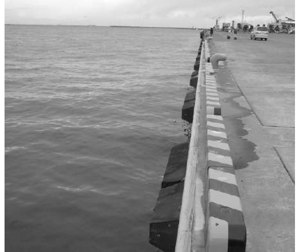
写真-6.1.1.11 八太郎地区N岸壁の法線の状況 (平成23年3月17日撮影)
