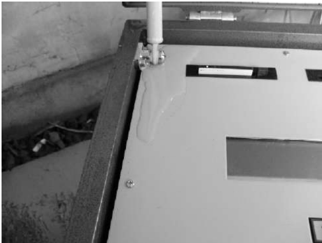
写真-2.2.2.4 八戸港の強震観測小屋 —躯体内部にわずかに浸入していた海水— (平成23年3月17日撮影)
