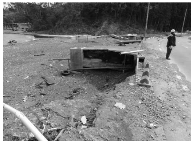
写真-5.3.2.7 唐桑町石浜にある漁港背後道路の洗掘
