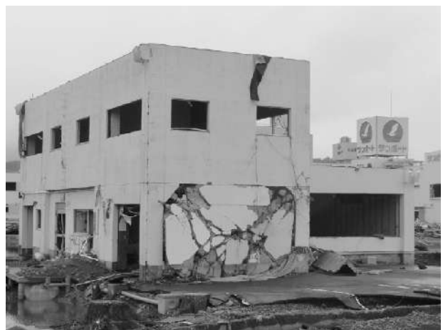
写真-5.3.3.2 2階建ての建物の壁面破壊
