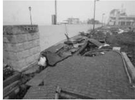
写真-6.3.26 仙台塩釜港（塩釜港区） 観光棧橋堤内側の洗掘
