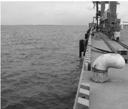
写真-6.1.1.5 八太郎地区J岸壁の法線の状況 (平成23年3月17日撮影)
