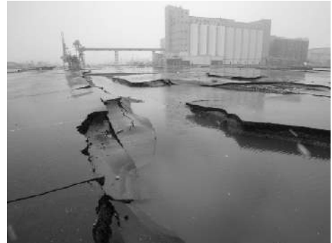
写真-6.3.6 日和埠頭南側の荷捌ヤードの損傷 (写真番号⑥)
