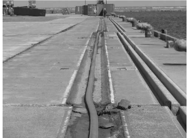
写真-6.5.2.2 北埠頭重力式岸壁(-12m)レールの湾曲 (2011年4月13日撮影)
