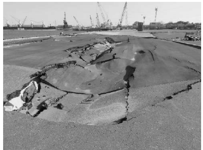
写真-6.5.4.5 南公共埠頭地区岸壁 C(-7.5m)陥没 (2011年4月12日撮影)
