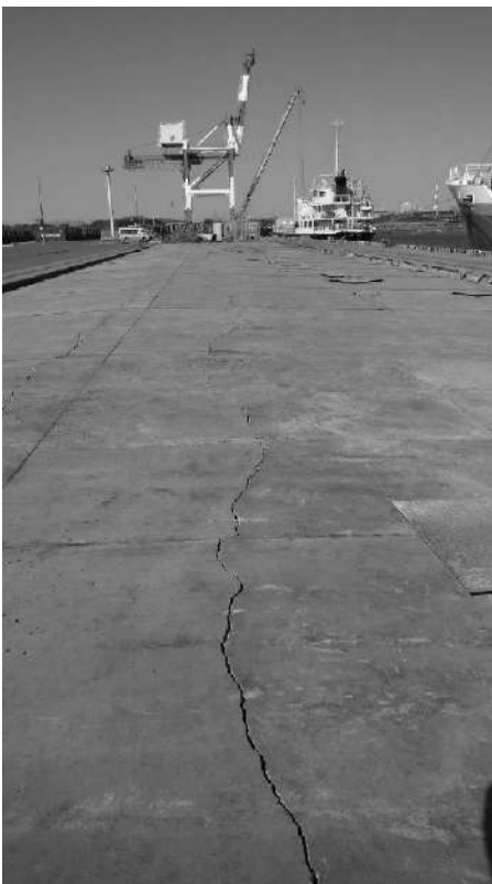
写真-6.5.4.4 北公共埠頭地区岸壁 D(-10m)クラック (2011年4月12日撮影)
