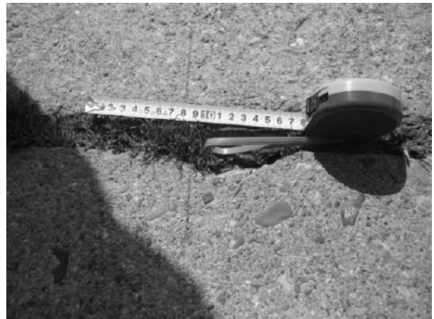
写真-6.2.3.2 栈橋ブロック間の相対ずれ
