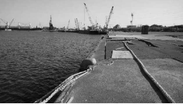
写真-6.5.4.6 南公共埠頭地区岸壁 C(-7.5m) (2011年4月12日撮影)
