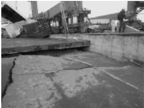
写真-6.3.18 高砂埠頭2号エプロン背後の被災状況 (写真番号⑪)
