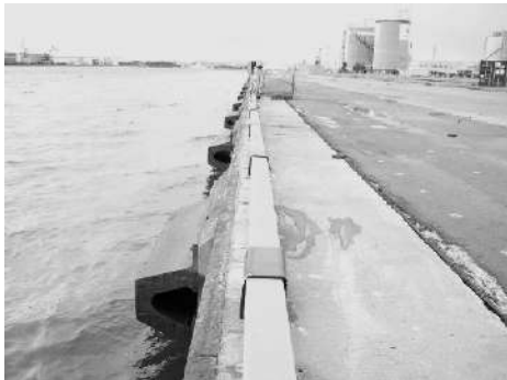
写真-6.3.13 中野埠頭 2号~4号岸壁の法線 (写真番号⑥)
