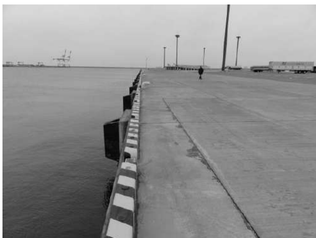
写真-6.5.2.4 中央埠頭重力式岸壁(-7.5m) (2011年3月13日撮影)
