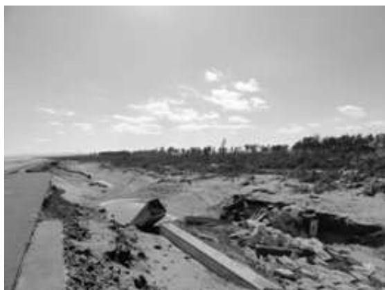
写真-5.3.8.4 護岸とその背後の洗掘（南側） （2011年3月18日撮影）
