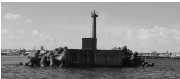
図-5.1.1.15 八太郎北防波堤の堤頭函周囲の被災状況
