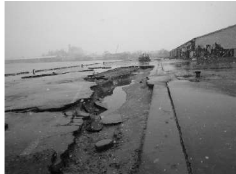
写真-6.3.2 大手埠頭の荷捌ヤードの損傷（写真番号②）
