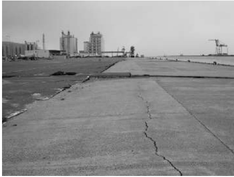
写真-6.3.11 中野埠頭 2号~4号岸壁のエプロン部の沈下 (写真番号④)
