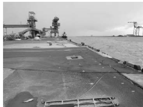
写真-6.3.10 中野埠頭1号～2号岸壁の取付部エプロンの沈下（写真番号③）
