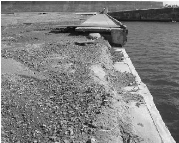
写真-6.2.1.3 諏訪下地区岸壁 (-10m) —取り付け部における上部工の流出— (平成23年3月18日撮影)
