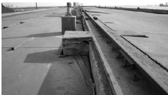
図-6.4.2.2 陸側レール部分の段差
