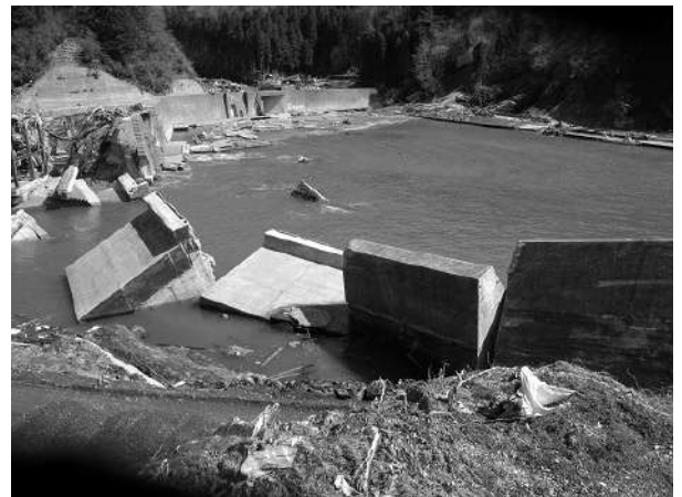
写真-5.2.3.20 両石地区の被災した防潮堤
