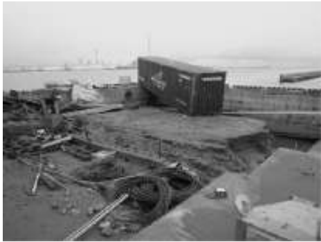
写真-6.3.17 高砂埠頭2号岸壁隅角部の被災状況 (写真番号⑩)
