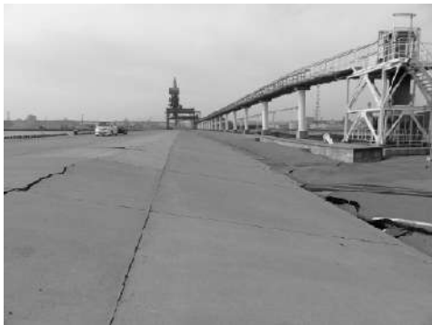
図-6.4.2.5 エプロン部の変状
