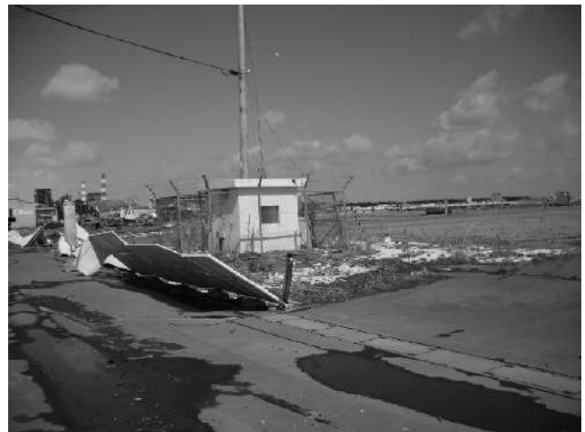
写真-2.2.2.2 八戸港の強震観測小屋 —地震後に津波を受けた様子— （平成23年3月17日撮影）
