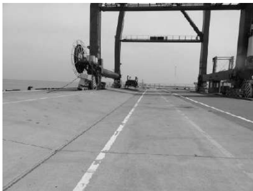
図-6.4.2.9 海側レールの損傷およびエプロン部の変状
