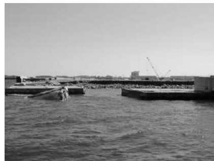
図-6.4.1.6 隅角部のケーソンの決壊
