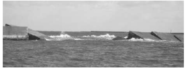
図-5.1.1.17 八太郎北防波堤の11工区の被災状況
