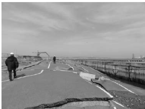
図-6.4.2.6 先端護岸背後の沈下・段差
