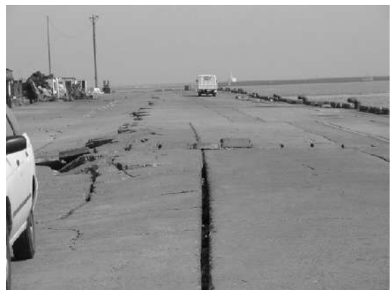
図-6.4.2.8 エプロンの変状
