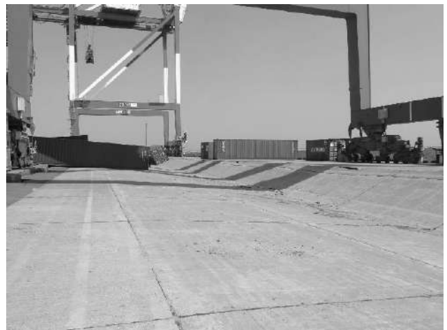
写真-6.5.2.3 北埠頭重力式岸壁(-14m)背後の沈下 (2011年4月13日撮影)
