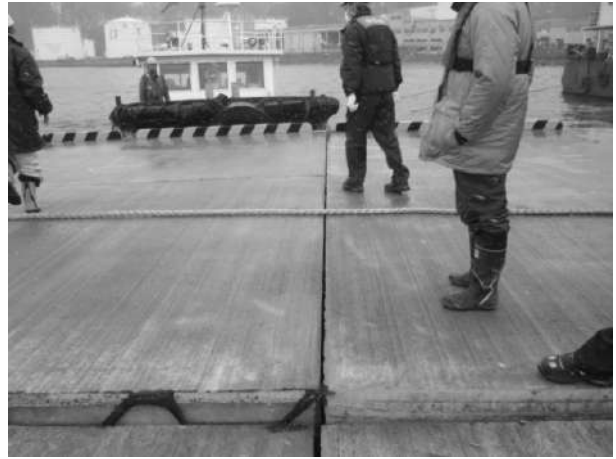
写真-6.2.2.10 突堤先端側取付部の傾斜
