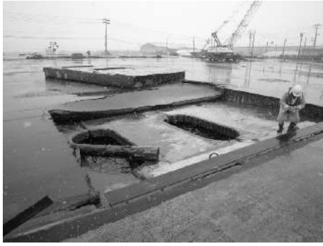
写真-6.3.3 大手埠頭棧橋部の舗装版の損傷 (写真番号③)
