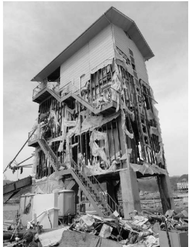
写真-5.2.5.1 海岸沿いに建っていた建物 (基礎部はコンクリートであるがそのほか鉄骨)
