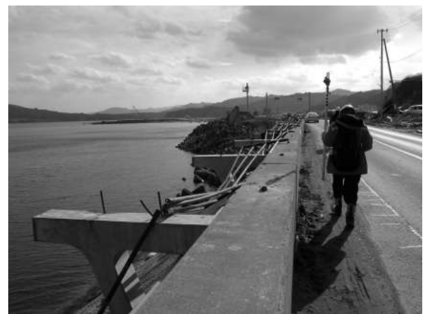
図-5.2.2.14 高浜地区の被災した遊歩道
