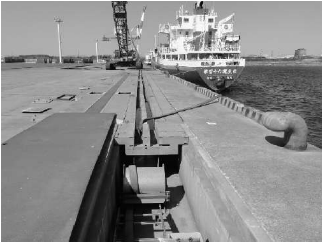
写真-6.5.4.3 北公共埠頭地区岸壁 D(-10m) ケーブル (2011年4月12日撮影)
