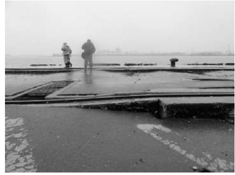
写真-6.3.5 日和埠頭のアンローダー用レールの沈下 (写真左が前面水深-9m側) (写真番号⑤)
