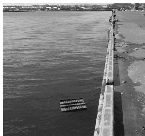
写真-6.1.1.3 八太郎地区P岸壁の地震後の法線の状況 (平成23年3月17日撮影)
