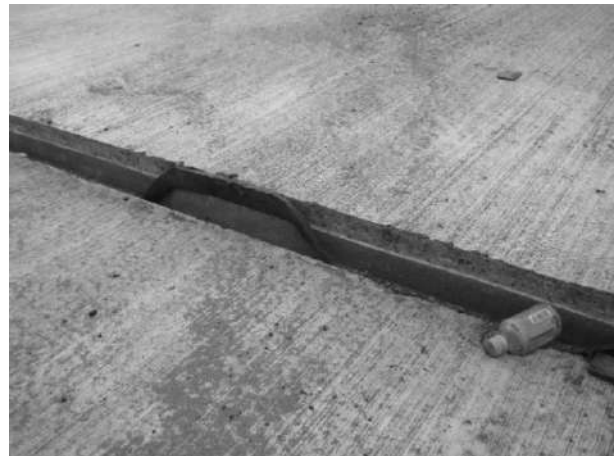
写真-6.2.2.8 背後との段差（10cm程度）
