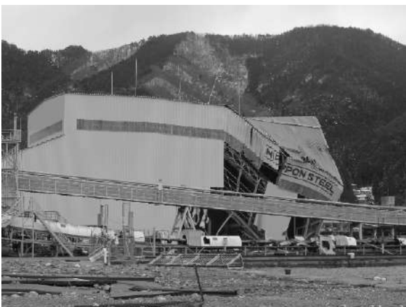
写真-5.2.3.6 船舶が衝突した上屋 (3月17日)
