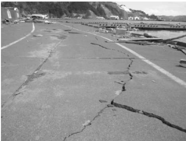
写真-6.2.2.20 アスファルト舗装の亀裂
