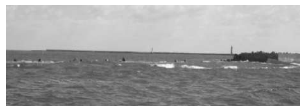
図-5.1.1.16 八太郎北防波堤の13工区の被災状況
