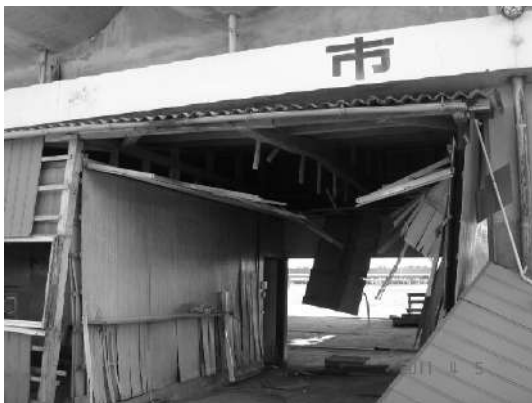
写真-5.5.4.6 大洗漁港背後の建物
