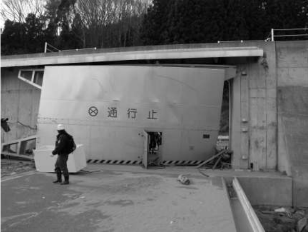
図-5.2.2.15 高浜地区の変形した陸閘
