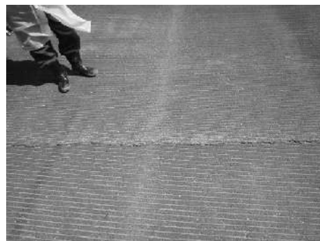
写真-6.3.24 仙台空港 B 滑走路上の亀裂 (写真番号③)
