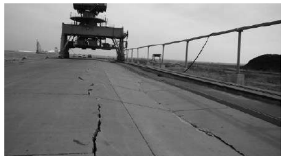
図-6.4.2.4 エプロン舗装部の変状
