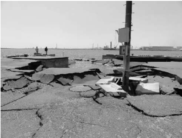
写真-6.5.1.1 第2埠頭重力式岸壁(-7.5m)隅角部 (2011年4月14日撮影)
