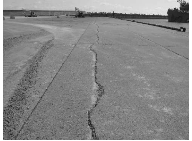
写真-6.2.1.1 諏訪下地区岸壁 (-10m) —岸壁法線に沿って存在する古いクラック— (平成23年3月18日撮影)
