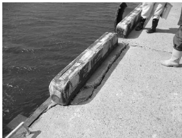
写真-6.2.1.7 諏訪下地区岸壁 (-10m) —車止めの損傷— (平成23年3月18日撮影)
