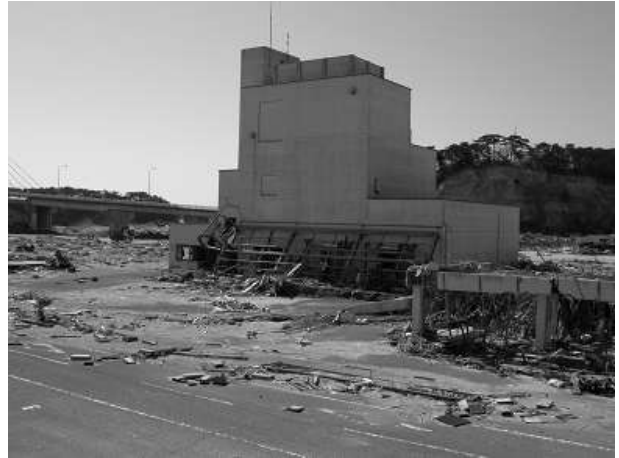
図-5.4.1.7 浸水部分が損壊した鉄筋コンクリート造の建物
