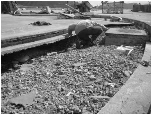
写真-6.2.3.7 背後地のエプロン下の状況
