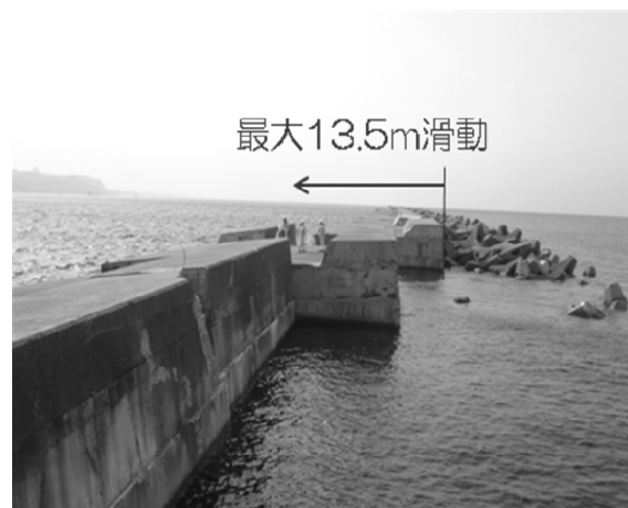
写真-3 寄り回り波の来襲による伏木富山港北防波堤のケーソンの滑動（最大13.5m滑動）
