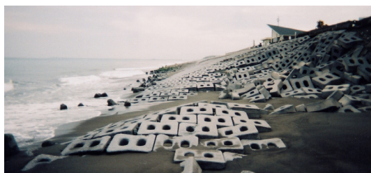
図-24 インナーバーの消滅後に見られた護岸の決壊
