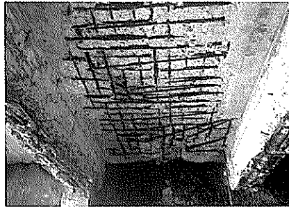
(b) はく離・はく落が多い (床版, はく落約 90%)
