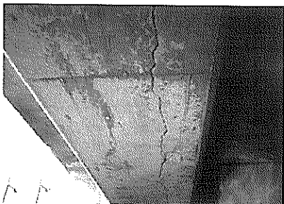
(d) 軸方向の腐食ひび割れ (はり, ひび割れ幅約 5mm)
