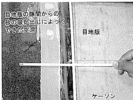
写真-6.3 埋立砂内の空洞
