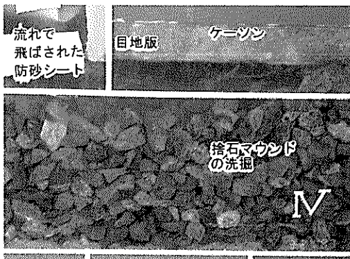
写真-3.20 目地板を切った場合の埋立砂の流失 (舗装板下の砂が吸い出されている)
