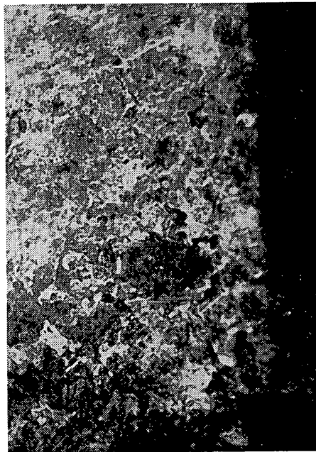
写真-5.15 門扉スキンプレート（下端の腐食）
