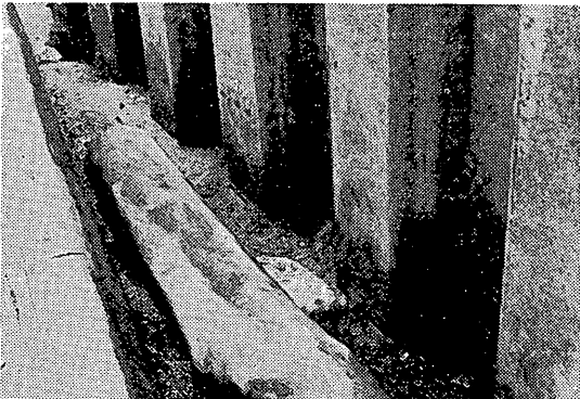
写真-5.6 今治港浅川荷揚場における干潮時の鋼矢板面 (40 年経過)
