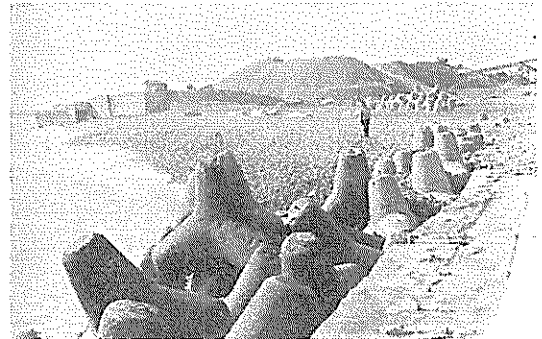
写真一.1.106 大井川港南防波堤元付部附近、ここも、最近 は欠壊気味という
