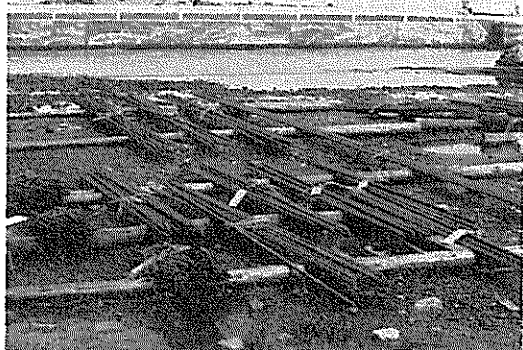
写真-2.10 鉄筋の貯蔵状態 (1) (M港工事事務所)
