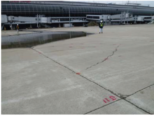
写真-3.2 仙台空港エプロンのひび割れと局所沈下の被害 11) 、2011年3月25日夜間から26日早朝にかけての降雨により発生した水たまり
