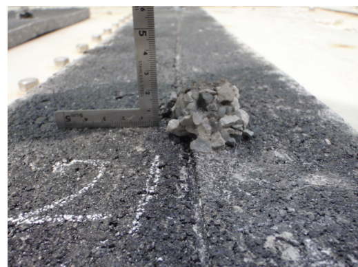
b) 舗装裏側の碎石の固化状況（削孔番号 21）
