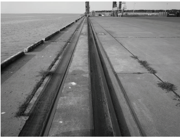
写真-5.4 ガントリークレーンのレール
