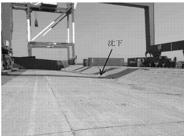
写真-1.1 常陸那珂港の被災状況
