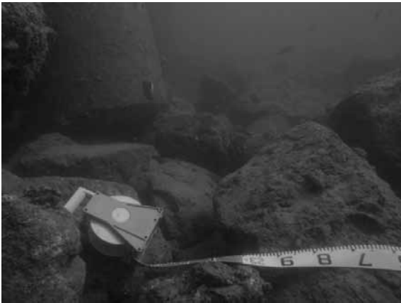
(c) 法線直角方向 23m 付近（トリバー10t 撤去部） 土砂の堆積が見られるが、捨石の間隙は空隙が残る
