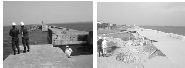
(a) 防波堤 (b) 緑地護岸 写真-3.1 伏木富山港の被災状況
