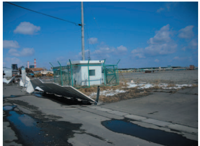
図-26 八戸港の強震観測小屋（津波による影響） （平成 23 年 3 月 17 日撮影）
