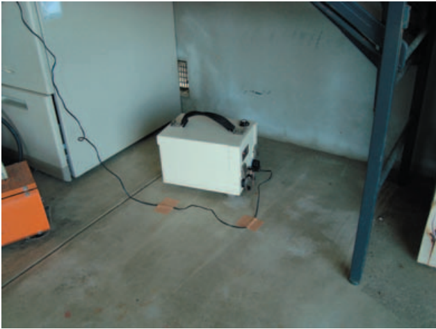
写真-3.3 久慈港における地震計の設置状況
