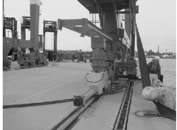
写真-6.1.1.6 八太郎地区J岸壁 —津波による被害を受けたクレーンの走行装置— (平成23年3月17日撮影)
