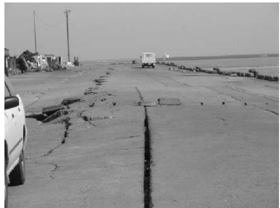
図-6.4.2.8 エプロンの変状
