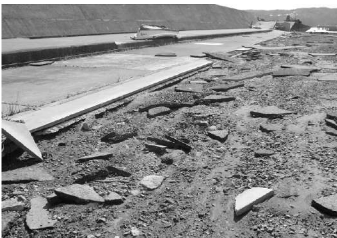
写真-6.2.1.5 諏訪下地区岸壁 (-10m) —取り付け部背後のアスファルト舗装の破損— (平成23年3月18日撮影)
