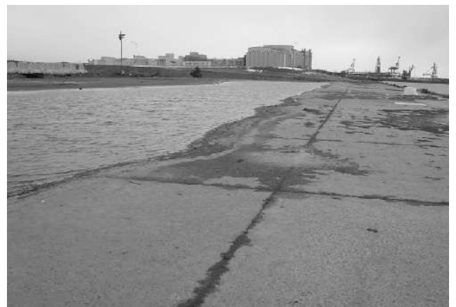
写真-6.1.1.12 河原木地区A岸壁背後の水たまり (平成 23 年 3 月 17 日撮影)
