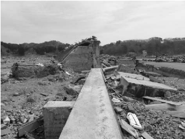
写真-5.2.5.2 防潮堤の転倒（右が海側）
