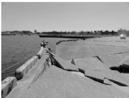
図-6.4.1.2 隅角部の破損状況
