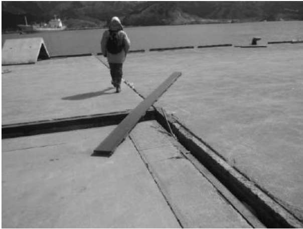
写真-6.2.3.3 背後との段差
