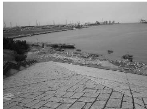
写真-6.3.21 中央公園の被災状況 (写真番号⑭)
