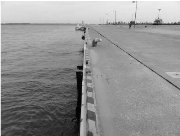
写真-6.5.3.3 第4埠頭岸壁(-8m) (2011年4月12日撮影)
