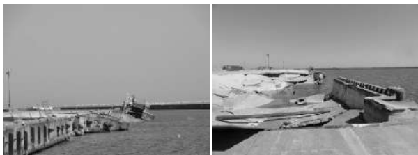
図-6.4.1.4 矢板岸壁の破損状況
