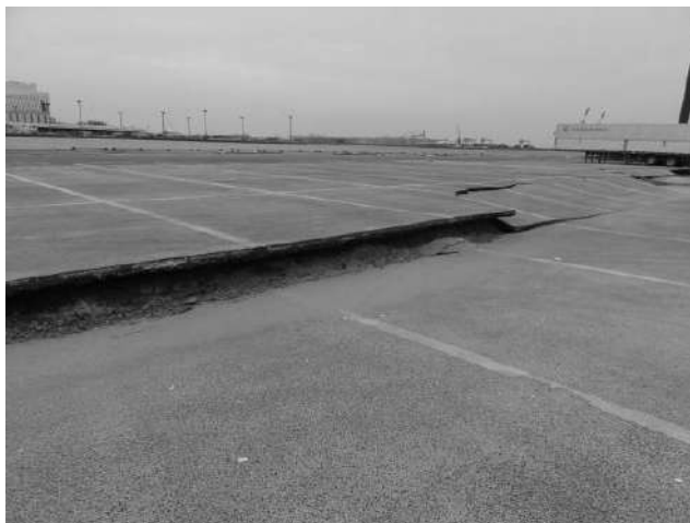
写真-6.5.2.5 中央埠頭重力式岸壁(-9m)地盤改良部と埋め土部の段差(2011年3月13日撮影)
