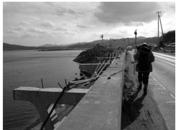
図-5.2.2.14 高浜地区の被災した遊歩道
