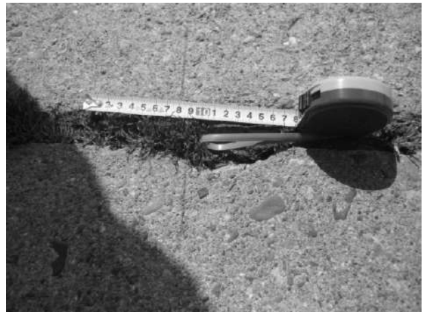
写真-6.2.3.2 栈橋ブロック間の相対ずれ
