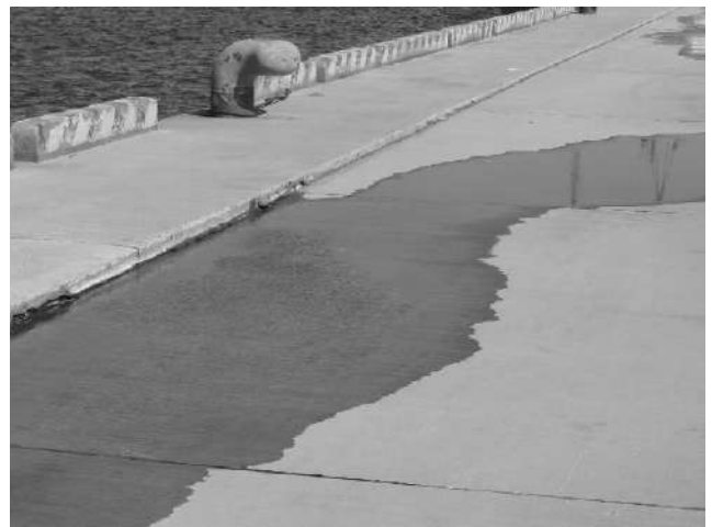
写真-6.5.4.2 北公共埠頭地区岸壁 C(-10m) (2011年4月12日撮影)
