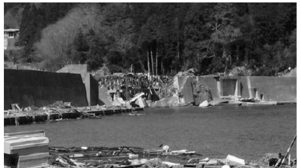
写真-5.2.3.21 両石地区の被災した防潮堤の遠景
