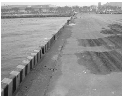
写真-6.1.1.10 八太郎地区L岸壁の法線の状況 (平成 23 年 3 月 17 日撮影)
