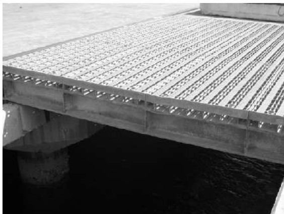
写真-6.2.1.13 諏訪下地区栈橋 (-7.5m) —津波で飛ばされなかったグレーチング式の渡版— (平成23年3月18日撮影)
