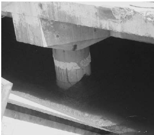
写真-6.2.1.12 諏訪下地区栈橋 (-7.5m) —落下した渡版による鋼管杭防食工の損傷— (平成23年3月18日撮影)
