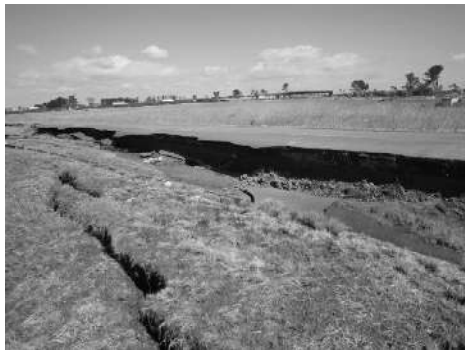
写真-6.3.23 仙台空港取付誘導路 B-6 付近の場周道路被災状況 (写真番号②)
