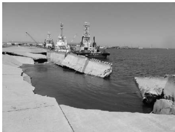
図-6.4.1.3 矢板岸壁の破損・洗掘状況
