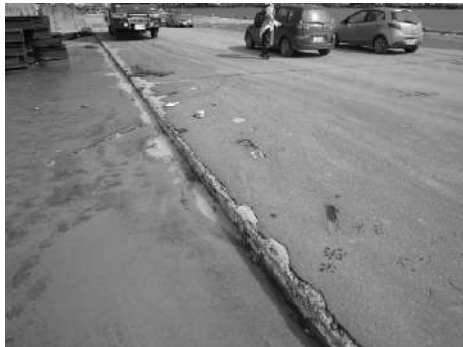
写真-6.3.9 高松埠頭エプロン背後の段差（写真番号②）
