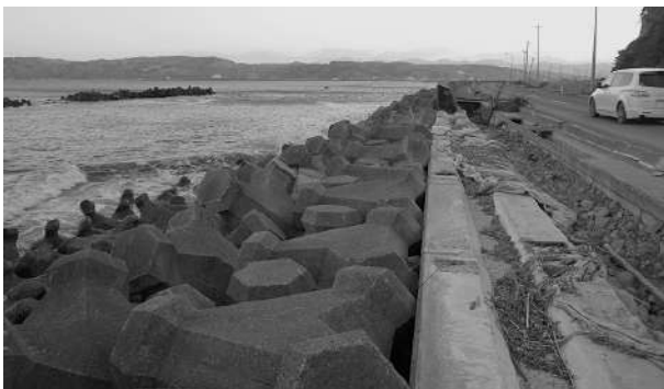
図-5.2.1.11 被災した海岸護岸（上：陸側に飛ばされたパラペット，下：海側にある消波ブロックと離岸堤）
