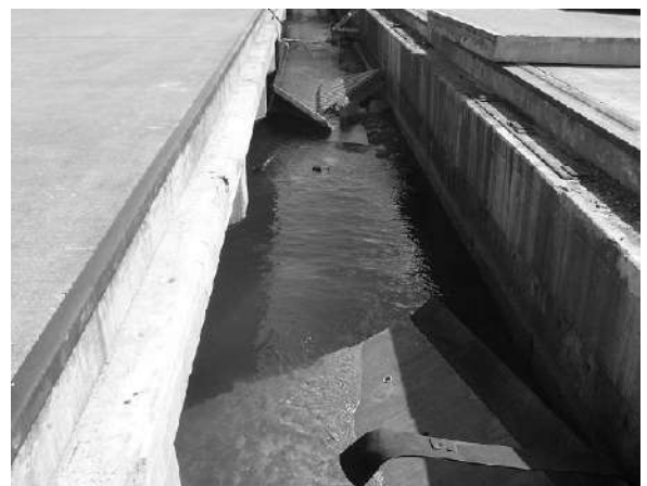
写真-6.2.1.11 諏訪下地区栈橋 (-7.5m) —津波による渡版の被害— (平成23年3月18日撮影)
