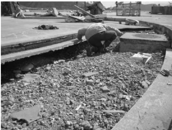
写真-6.2.3.7 背後地のエプロン下の状況
