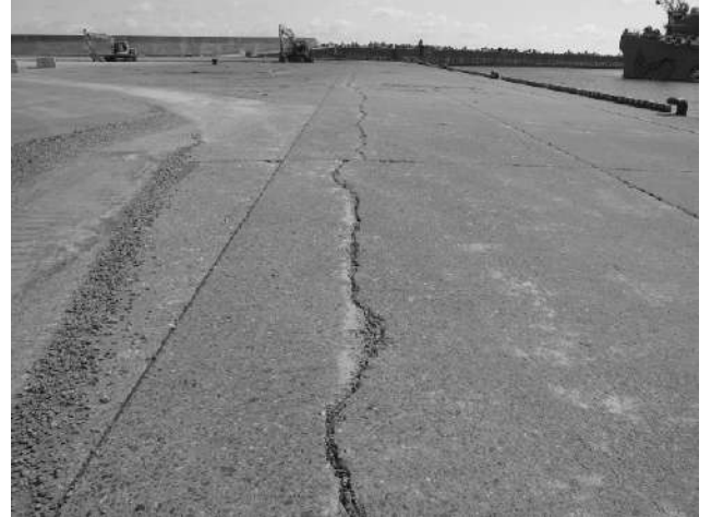
写真-6.2.1.1 諏訪下地区岸壁 (-10m) —岸壁法線に沿って存在する古いクラック— (平成23年3月18日撮影)
