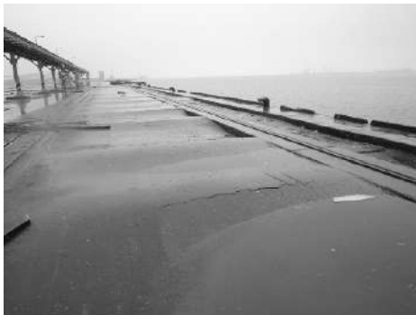
写真-6.3.4 日和埠頭の岸壁法線と背後の沈下 (写真番号④)
