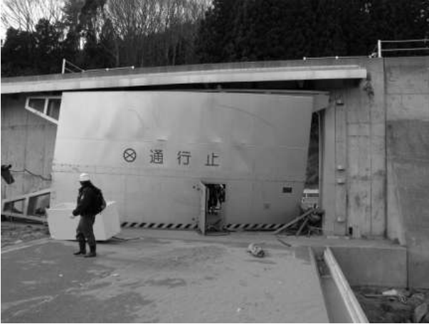
図-5.2.2.15 高浜地区の変形した陸閘
