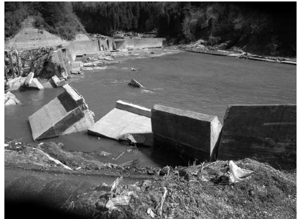
写真-5.2.3.20 両石地区の被災した防潮堤
