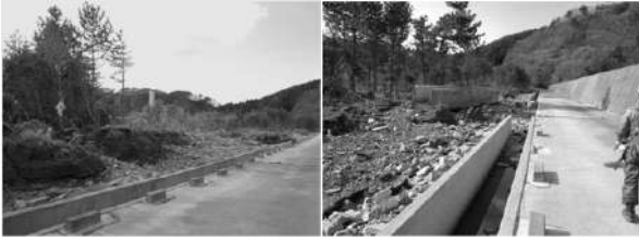
写真-5.2.3.16 東側の消波護岸背後の洗掘と倒れた松林
