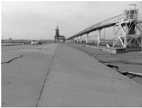
図-6.4.2.5 エプロン部の変状
