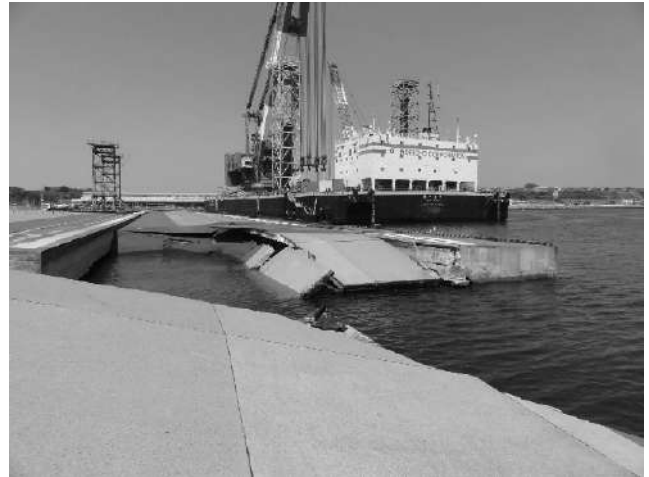
写真-6.5.1.2 第4埠頭重力式岸壁(-10m)隅角部 (2011年4月14日撮影)
