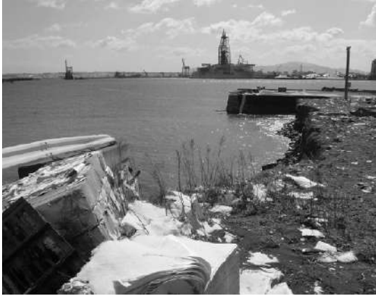
写真-6.1.1.4 八太郎地区P岸壁 —取り付け部護岸の流出— (平成23年3月17日撮影)
