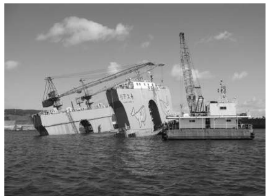
図-5.2.1.15 諏訪下地区におけるFDの被災
