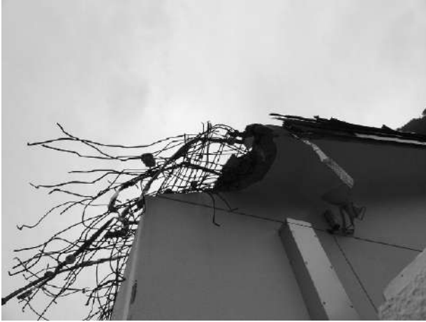
写真-5.2.5.8 下水処理場の屋根の破壊部分
