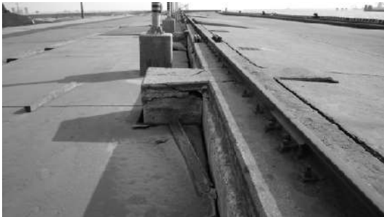
図-6.4.2.2 陸側レール部分の段差
