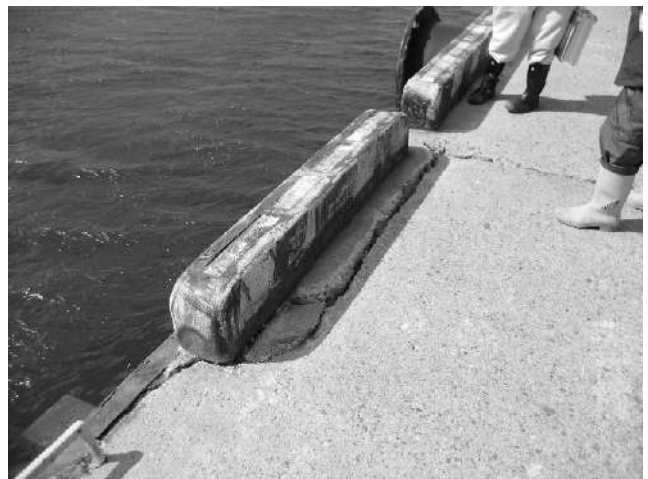
写真-6.2.1.7 諏訪下地区岸壁 (-10m) —車止めの損傷— (平成23年3月18日撮影)
