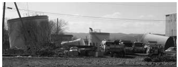
図-5.2.1.8 諏訪下地区のオイルタンクの被災
