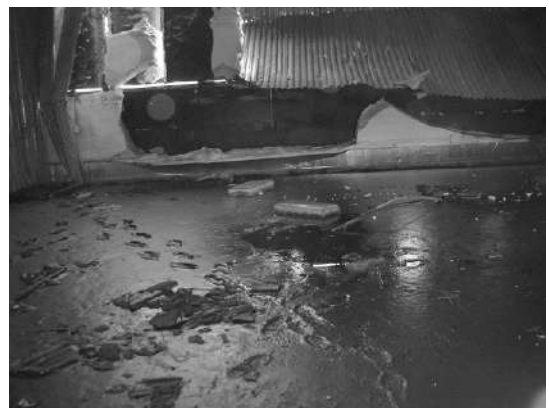
図-5.2.2.9 出崎埠頭上の建物1階床に堆積した泥
