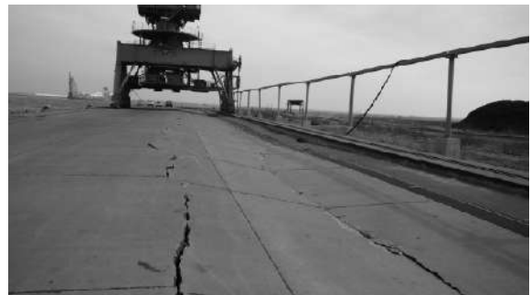
図-6.4.2.4 エプロン舗装部の変状
