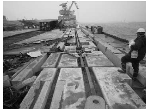
写真-6.3.20 高砂埠頭1号岸壁の免震レール (写真奥側が作動, 写真番号⑬)
