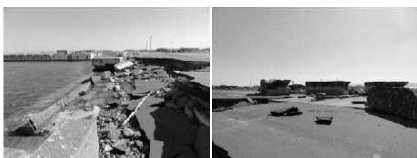
図-6.4.1.5 直立消波ブロック式護岸 移動・転倒したブロック
