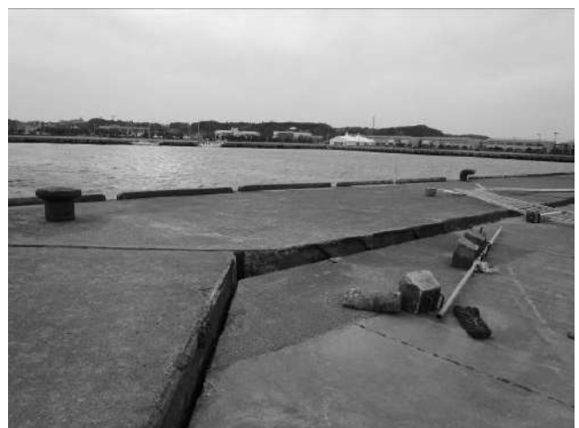
写真-6.5.3.2 第3埠頭岸壁(-8m)西側フェリーターミナル隅角部（2011年4月12日撮影）
