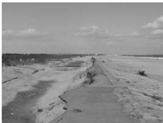
写真-5.3.8.3 護岸とその背後の洗掘（北側）（2011年3月18日撮影）
