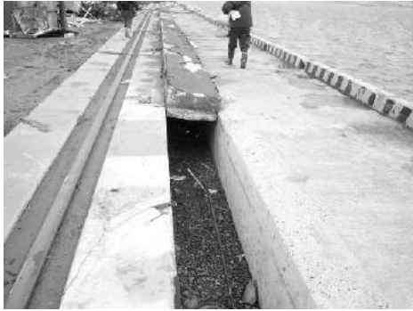
写真-6.3.16 高砂埠頭2号岸壁の 矢板上部工と海側レール間の空洞 (写真番号⑨)
