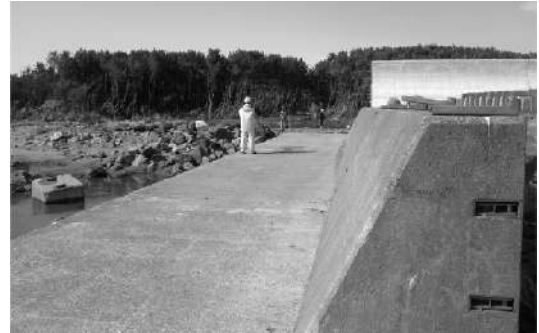
図-5.1.1.11 護岸背後の地盤の状況
