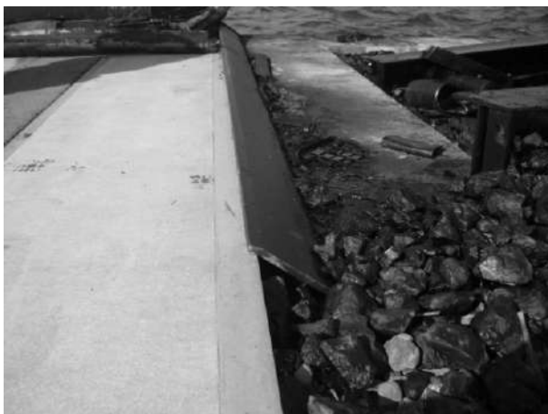
写真-6.2.3.9 背後との段差 (15cm 程度)
