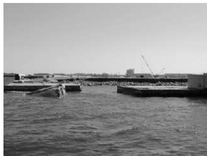
図-6.4.1.6 隅角部のケーソンの決壊
