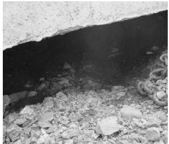
写真-6.2.1.15 諏訪下地区栈橋 (-7.5m) —舗装下の空洞— (平成23年3月18日撮影)
