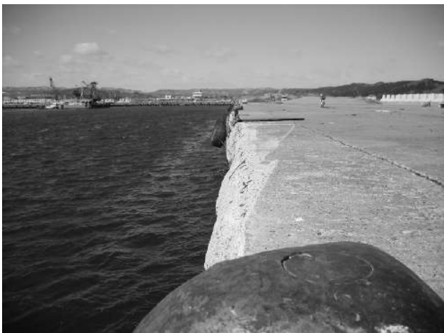
写真-6.2.1.4 諏訪下地区岸壁 (-10m) —上部工の損傷— (平成23年3月18日撮影)
