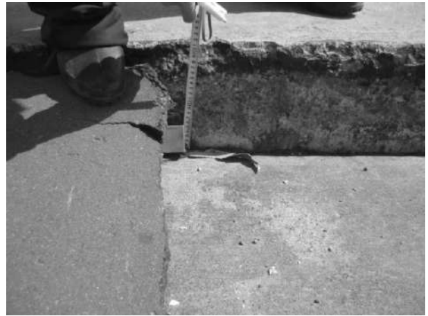
写真-6.2.3.6 背後との段差
