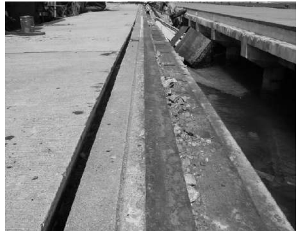
写真-6.2.1.14 諏訪下地区栈橋 (-7.5m) —コンクリート舗装と土留め壁の間の開き— (平成23年3月18日撮影)
