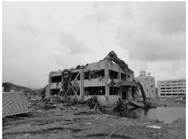
写真-5.3.3.1 3階建ての建物の3階部分の柱折れ
