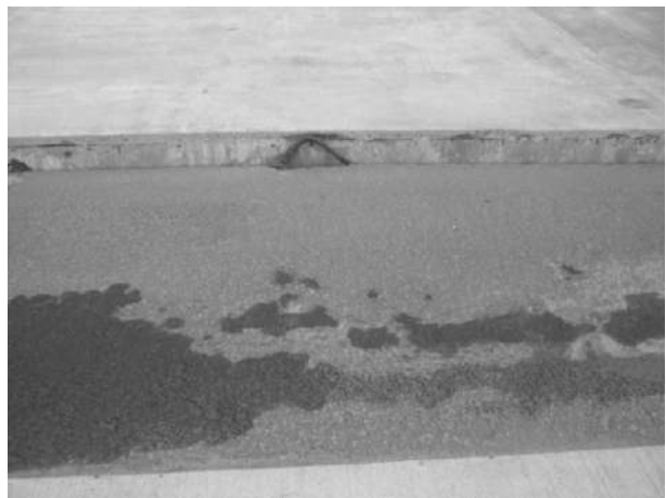
写真-6.2.2.4 背後との段差（10cm程度）
