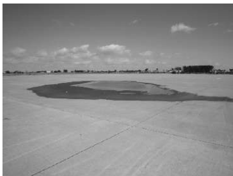
写真-6.3.22 仙台空港エプロン部の沈下 (写真番号①)
