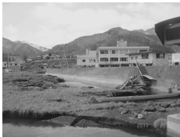
写真-5.2.4.4 防潮堤の洗掘
