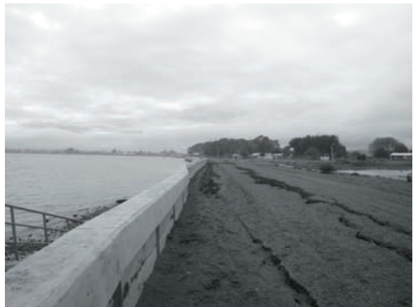
写真-4.22 測線L9付近の海岸線を撮影、地震動による地割れと護岸の張り出し
