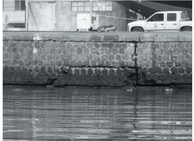
写真-5.2 タルカワノ港 ブロック積護岸の被災状況
