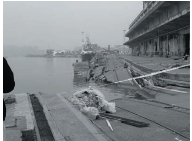
写真-5.3 タルカワノ港 矢板岸壁の被災状況
