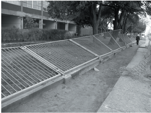
写真-4.2 コンテナの衝突により倒れた中学校のフェンス（4月27日撮影）
