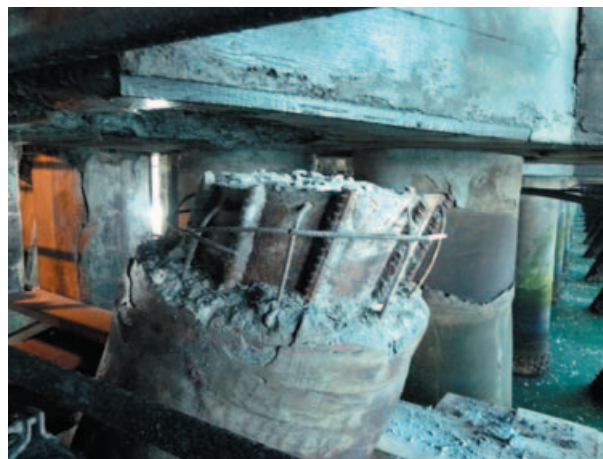
写真-5.6 ワチパト製鉄会社専用縦棧橋 杭頭部の破損状況 (φ900mm程度)
