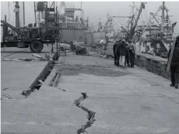
写真-5.1 タルカワノ港 重力式岸壁の被災状況
