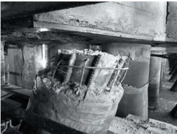
写真-5.6 ワチパト製鉄会社専用縦棧橋 杭頭部の破損状況 (φ900mm 程度)
