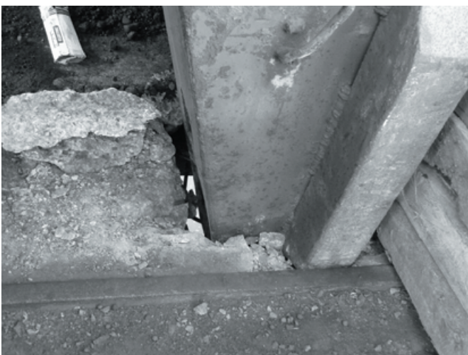
写真-5.7 ワチパト製鉄会社専用縦棧橋 荷役機械の脱輪により、棧橋床版を貫通したアンカー
