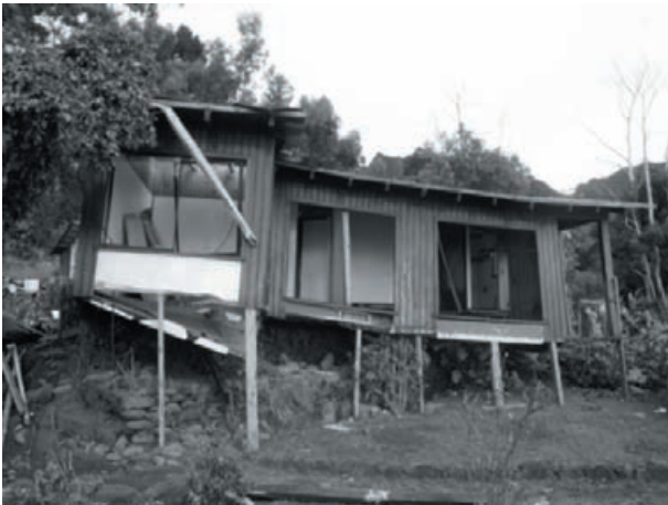
写真-4.20 村南部に位置する損壊した家屋
