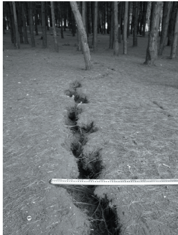
写真-4.26 測線 L10 から L11 に向かう場所での地割れ
