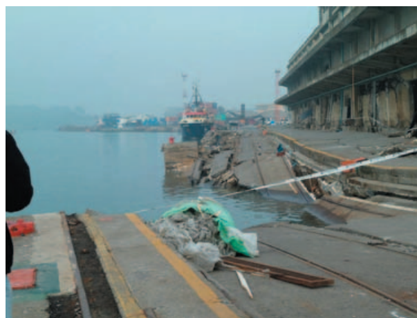
写真-5.3 タルカワノ港 矢板岸壁の被災状況
