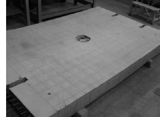
写真-4.4 試験体上面の破壊状況 (F-1試験体)
