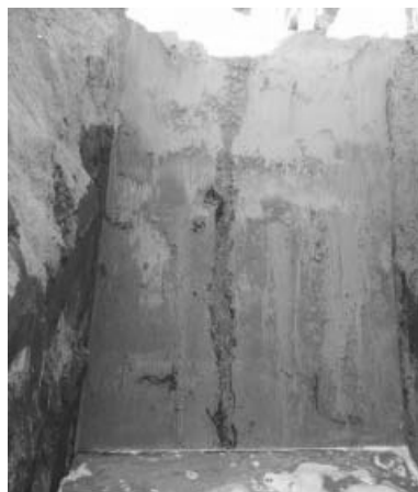
図-2.1.3 釧路港西港区第4埠頭固化処理土の亀裂
