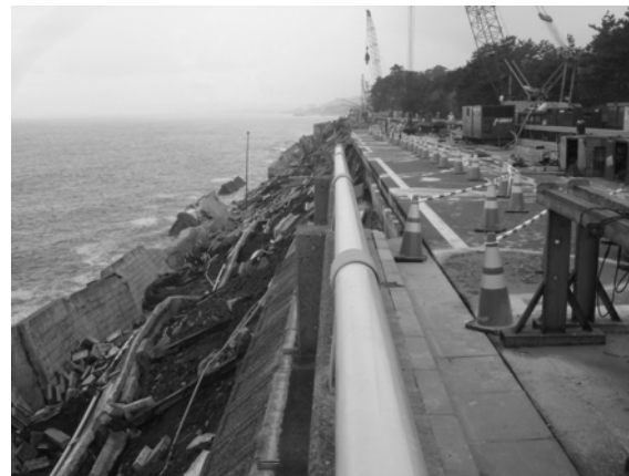
写真-2 台風0709号の来襲による西湘バイパスの一部崩壊（延長1.1km）
