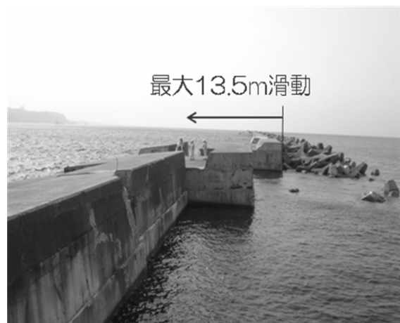
写真-3 寄り回り波の来襲による伏木富山港北防波堤のケーソンの滑動（最大13.5m滑動）
