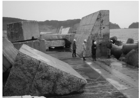
写真-1 台風0612号による久慈港半崎地区の護岸の一部損壊
