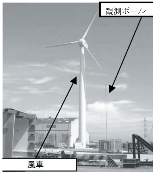
写真-3.4 風車の外観
