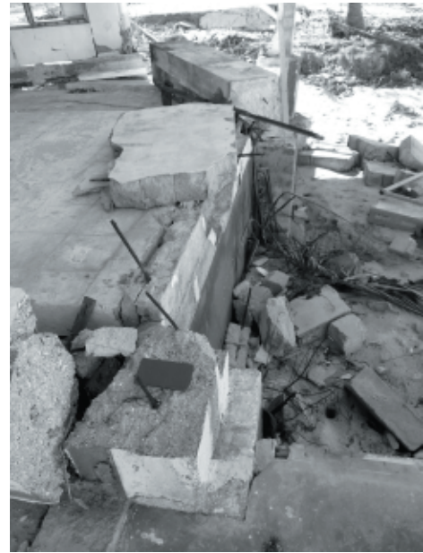
写真-14 建物②の海岸側の壁面の破損
