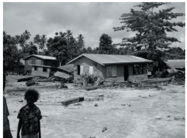
写真-37 流された建物②の上部建物
