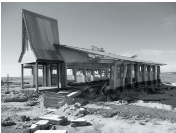
写真-13 図-14 の建物②の破壊状況
