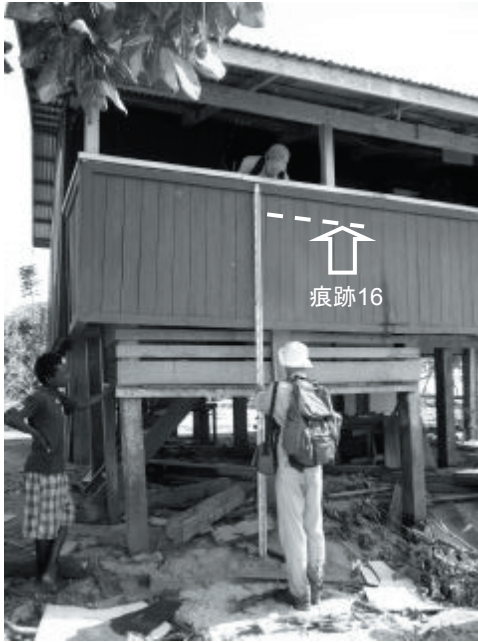
写真-36 痕跡16の建物を北東側から撮影
