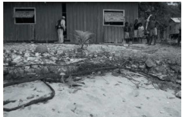
写真-31 植生の根により防がれた侵食
