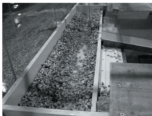
写真-6 石材飛散状況(津波高 2m)
