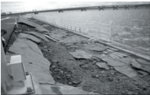
写真-1 被災状況
