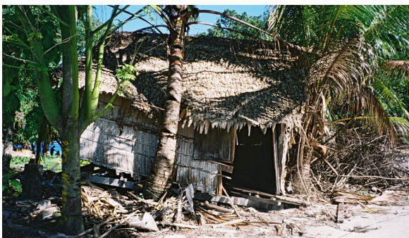
(2) 高床式住居の基礎洗掘（ギゾ島）（根入れが浅いものは倒壊していたが、90cm以上の根入れ長があるものは残っていた）
