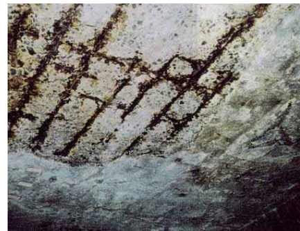
写真-1 栈橋上部工における塩害劣化事例
