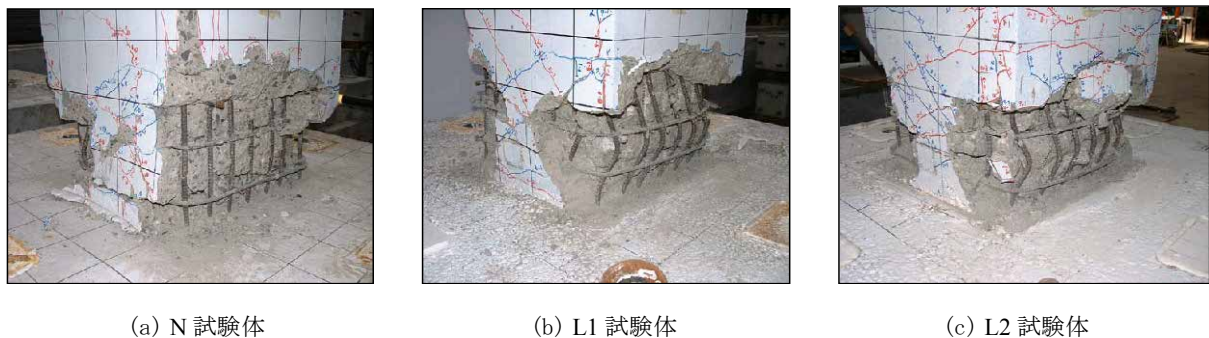
写真-7 柱基部損傷状況
