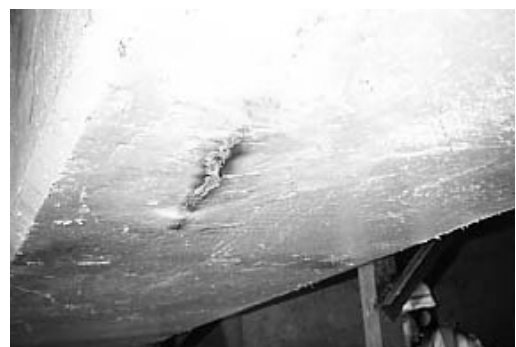
写真-1 表面被覆後に確認された腐食ひび割れ
