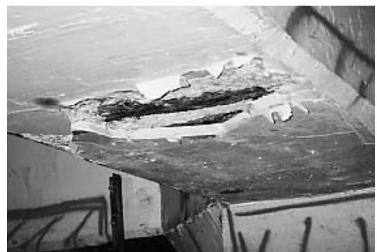
写真-2 被覆材の剥離
