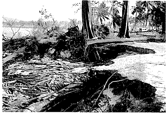
(b) 海岸道路の流出(2mの段差が生じている)
