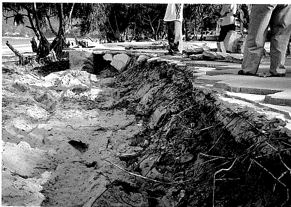
巻頭写真-4 パトンビーチの海浜侵食の様子 (2005. 1. 1) (海岸護岸が侵食によって崩落している。侵食された深さは1m程度である)
