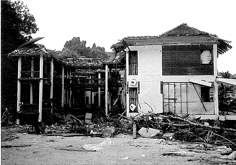
巻頭写真-1 タイ、カオラック (Khao Lak) 海岸のホテル被災 (2004. 12. 31撮影) (2階の床上方に泥跡があり、屋根まで漂流物が打ち上げられている。痕跡高は海面より約10mである)
