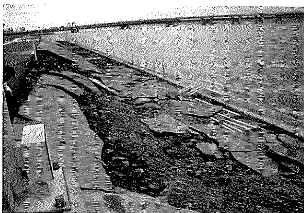
写真-2.4.5 C 護岸場周道路のり面崩壊 (平成16年8月31日撮影) (出典 関西国際空港株式会社)
