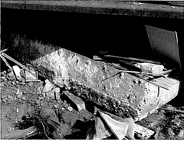
写真-2.5.4 被災した上部パラペット②
