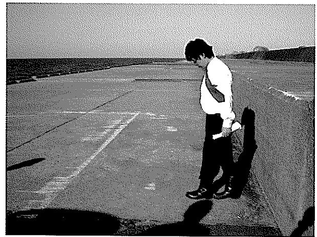
写真-2.3.10 上部パラペット落下痕跡(宮崎港)
