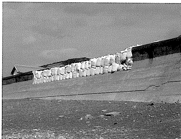
写真-2.5.2 護岸の被災状況
