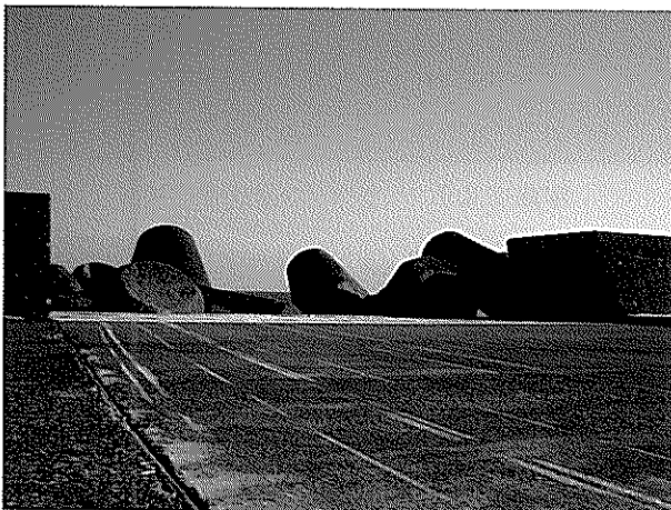
写真-2.3.8 上部パラペット被災状況(宮崎港)
