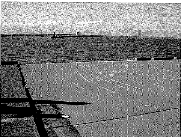
写真-2.3.9 上部パラペット移動痕跡(宮崎港)
