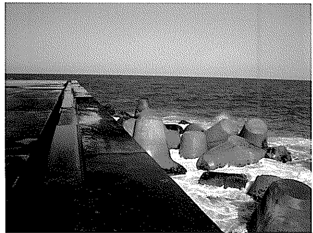
写真-4.2.2 消波ブロック破壊状況 (宮崎港)
