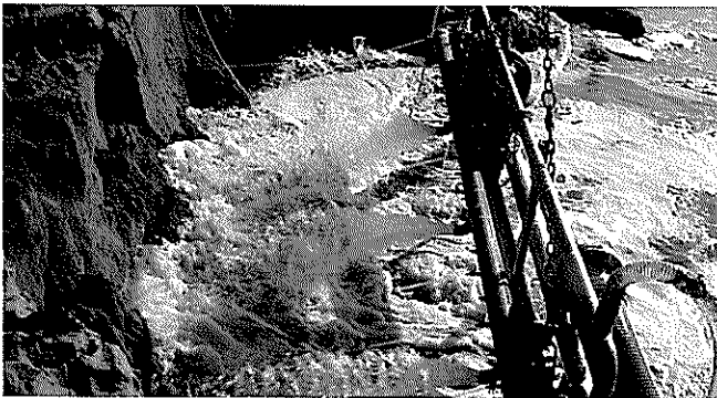
写真-13 給水ポンプ稼働状況
