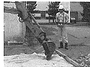
写真-1 携帯型操作装置の操作状況
