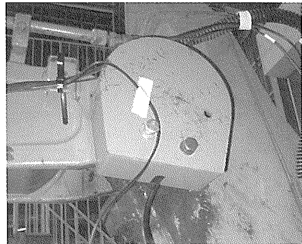
写真-7 アーム軸ポテンシオメータ取付状況
