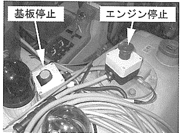
写真-3 非常停止ボタン
