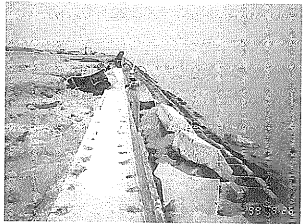
写真-4.1 パラペットの倒壊
