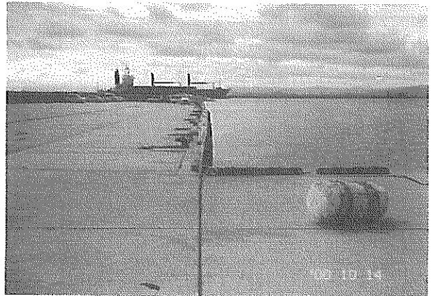
写真-3.1.7 昭和北物揚場㊟ 法線の水平変位全景
