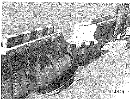
写真-3.5.3 物揚場(-3.0m)(施設番号⑥)の上部工の崩壊
