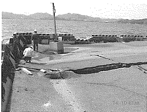
写真-3.5.1 物揚場(-3.0m)(施設番号⑥)の隅角部の被害
