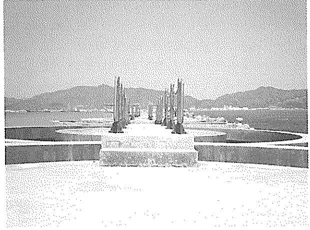
写真-3.1.24 沖防波堤南端部(22) 地震後の状況
