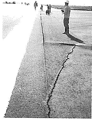
写真-3.6.2 滑走路路肩部分のクラック (図-3.6.3①)
