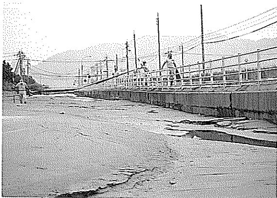
写真-3.1.1(a) 承水路河床の盛上がり
