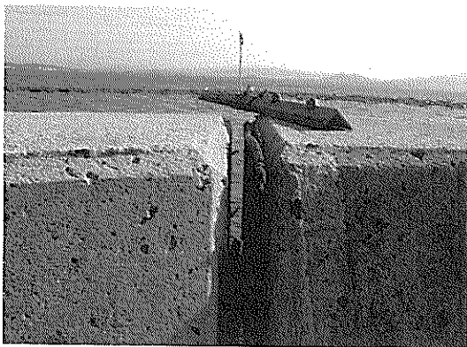
写真-3.6.5 護岸目地部開き (図-3.6.3⑧)
