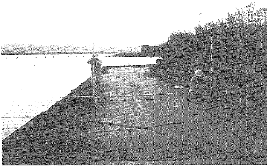
写真-3.4.1 松江港馬潟地区 物揚場 (-2.0m) 被災状況 (東側)
