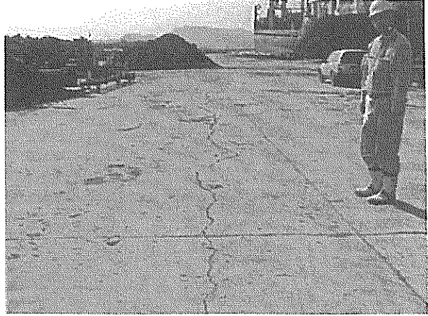
写真-3.1.12 江島1号岸壁⑱ エプロン部の亀裂
