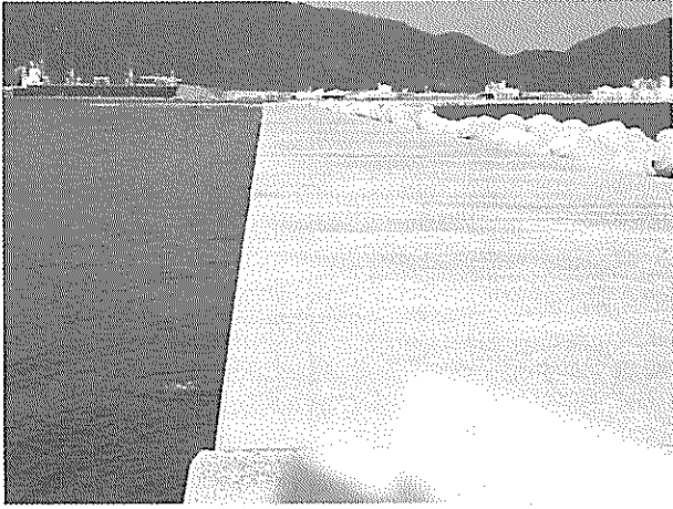
写真-3.1.21 沖防波堤(21) 地震後の状況
