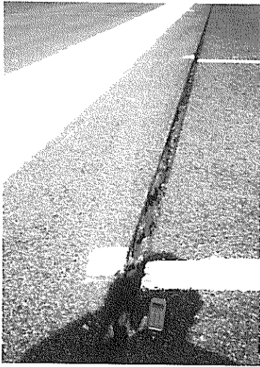
写真-3.6.1 滑走路路肩部分のクラック (図-3.6.3①)
