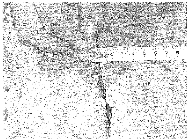
写真-3.1.13 江島1号岸壁⑱ エプロン部の亀裂
