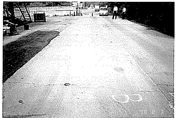
写真-8 横断ひびわれ発生状況
