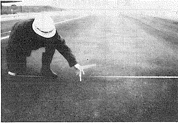
写真-1 わだち掘れ状況
