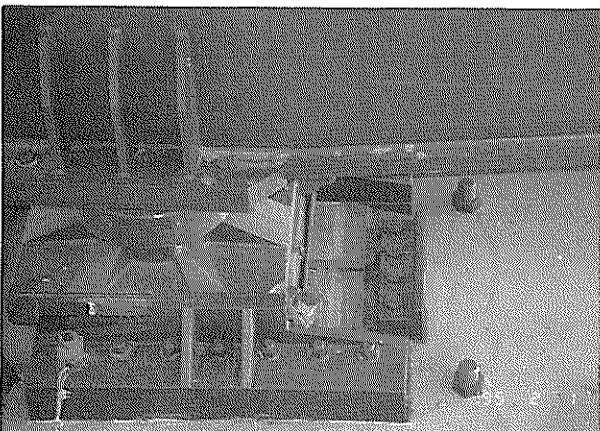
写真-3 P70 上可動沓の損傷
