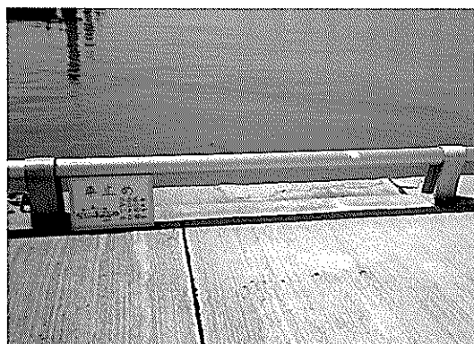
写真-8 車止め（大阪港）
