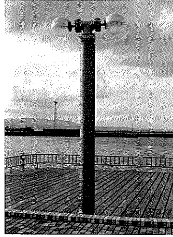
写真-14 照明設備（青森港）
