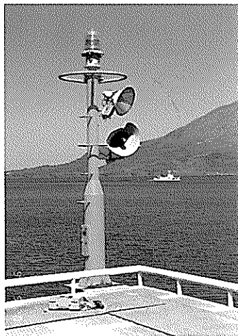
写真-17 警報設備・緊急通報設備（鹿児島港）
