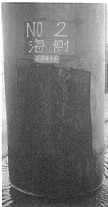
補修前，防食シートハガシ跡
