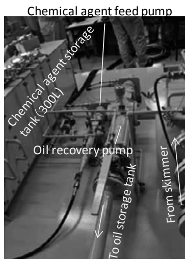
写真-7 薬剤注入装置
