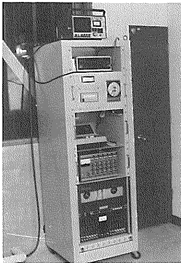
写真-10 監視制御装置
