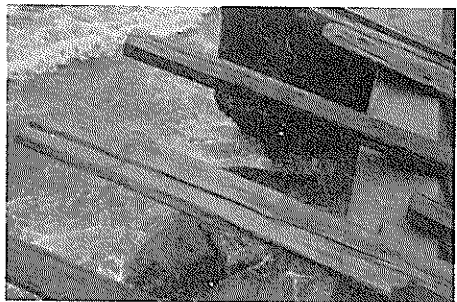
写真 - 5.82 岩盤との接続部の欠け
