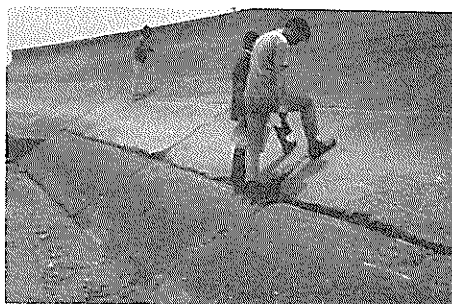
写真-6.45 表のり下部のコンクリート打継目の角欠け
