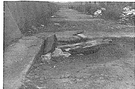
写真-5.121 裏込の吸出しによる水叩工の陥没
