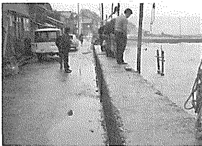
写真 - 5.26 水叩工の沈下(背後に水たまり)
