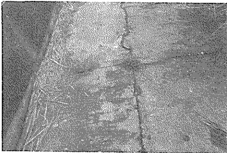
写真 - 5.59 天ば工のクラック
