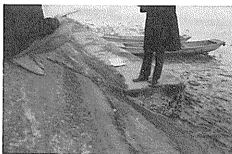
写真 - 5.51 表のり工の沈下によるずれ
