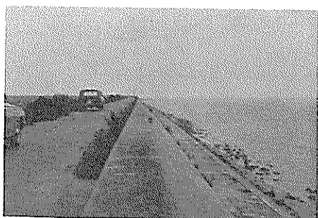
写真-6.23 表のり工および波返し工
