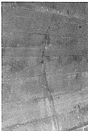
写真 - 5.93 波返し工の縦方向クラック
