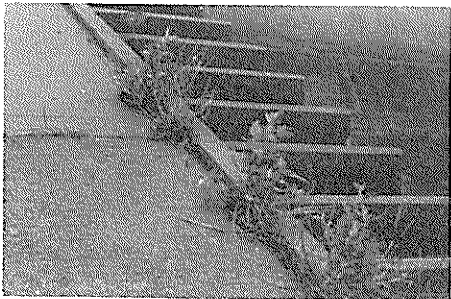
写真-6.42 天ば工の沈下による段差
