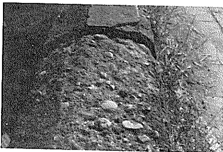
写真 - 5.72 波返しコンクリートの摩耗、沈下
