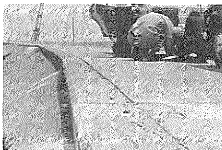
写真-6.2 天ば工と裏のり工との目地の段差
