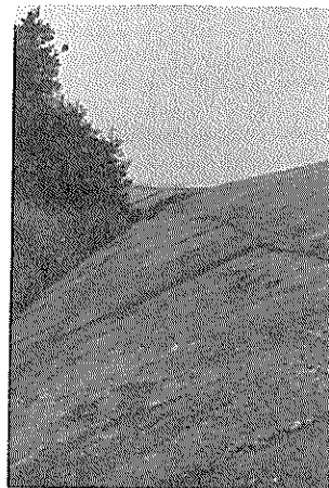
写真-6.48 裏のり被覆コンクリートの摩耗
