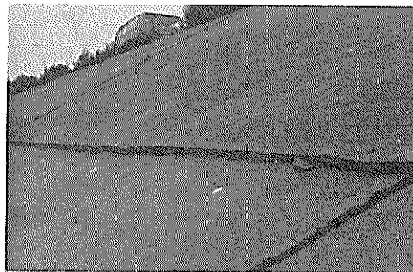
写真-6.28 裏のり工スラブの移動による段差
