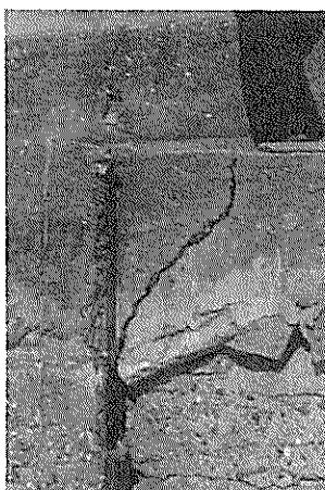
写真 - 5.38 表のり工のクラック
