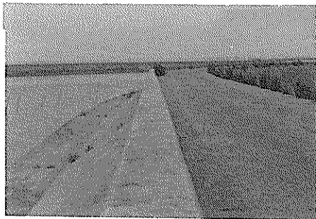
写真-6.19 表のり工および波返し工
