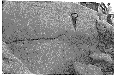
写真 - 5.88 表のり工のクラック
