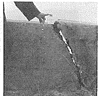
写真 - 5.61 波返し工の不等沈下によるクラック
