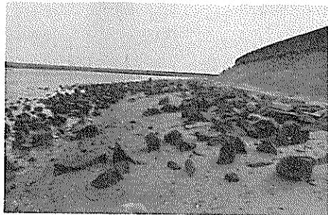
写真 - 5.47 前面根固石の散乱
