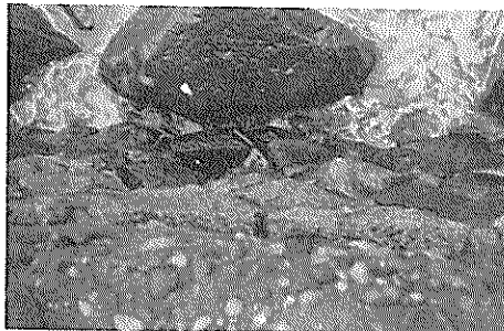
写真 - 5.30 表のり工間知石の抜け出し
