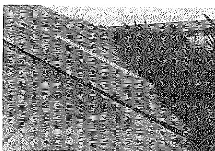
写真-6.16 裏のり工のはらみ
