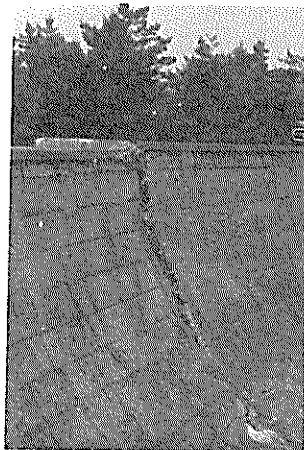
写真-6.47 波返し工 の目地の不陸と表面の摩耗
