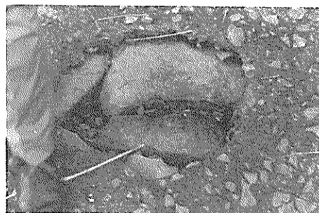
写真 - 5.65 表のり工小段部の内部捨石の露出
