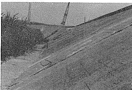
写真-6.3 裏のり工のはらみ
