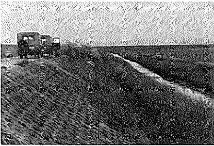
写真 - 5.66 裏のり工の状況（天ば、裏のりの不陸）
