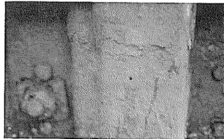
図2・18 付着物を除去した海面上鋼矢板面
