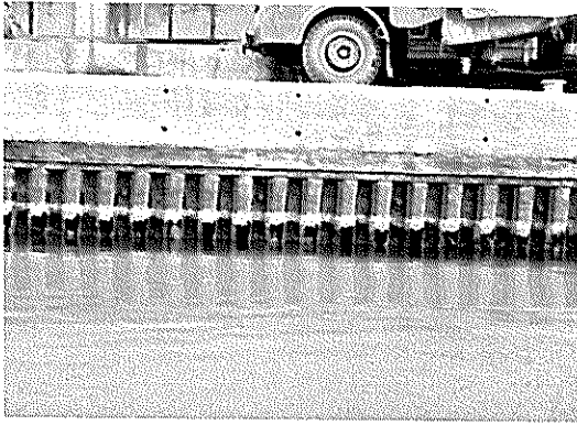
凸鋼矢板面の損傷状況 (恵曇港、35年経過、最干潮時)
