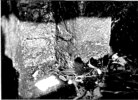
凸鋼矢板面の損傷状況 (恵曇港、35年経過)
