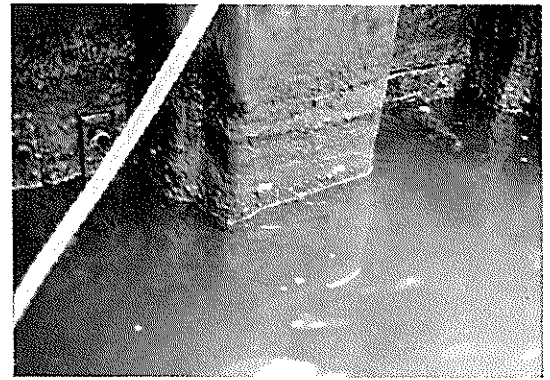
図 4-30 鋼矢板面 (安来港-4.5m岸壁、潮位間、35年経過)
