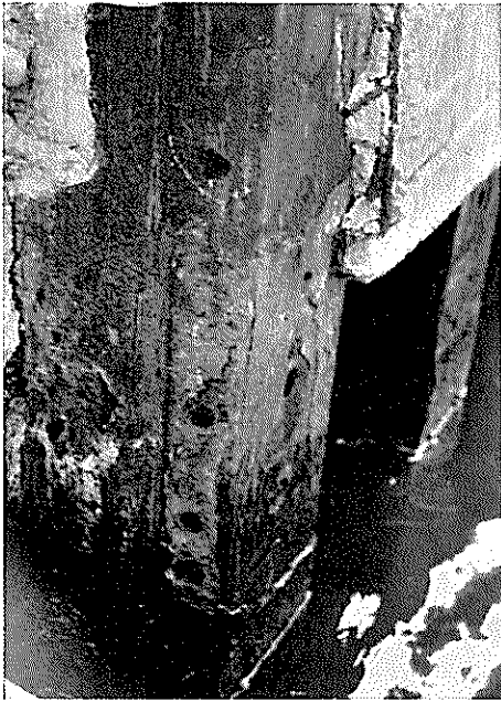
図 4-24 鋼矢板面 (安来港-4.5m岸壁、海水上、35年経過)
