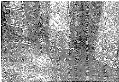
図 8.4 海水面付近における鋼製梯子使用状況
