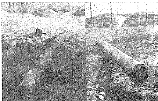
写真-5.1 Pile No. 2 および Pile No. 5 の塑性変形
