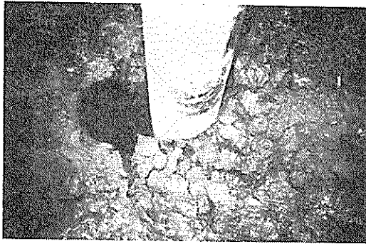
写真-5.2 Pile No. 2 地表面破壊状況
