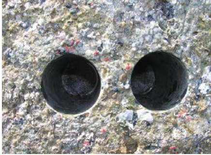
写真-7.4 コア採取孔内部の鋼材（鋼管杭）の腐食状況
