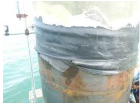
写真-5.15 No.35 杭のシュリンクチューブ補修試験部 (30年経過時)
