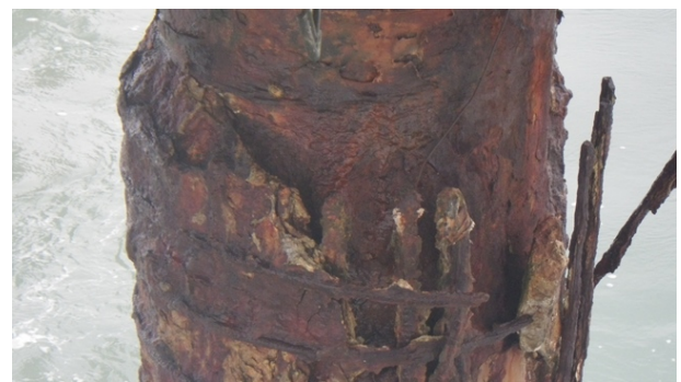
写真-7.17 30年経過時の被覆上端部の外観(2015年撮影)
