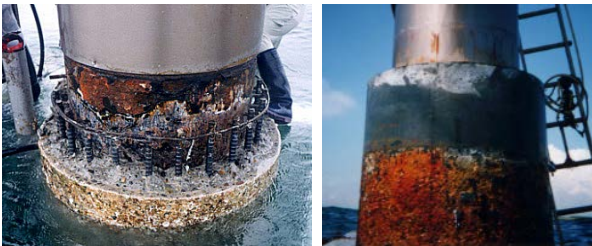
写真-7.5 打継面の目荒らし 写真-7.6 補修直後の状態 (1998年撮影)
