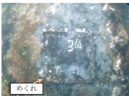
写真-5.18 No.34 杭の水中部の超音波溶着による補修部 (3年経過時)
