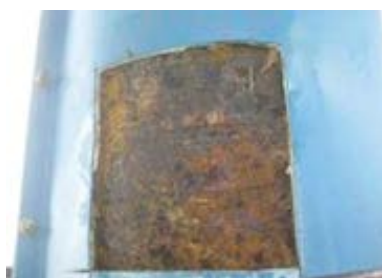
写真-6.3 鋼材の発錆状況 (No.19 杭)
