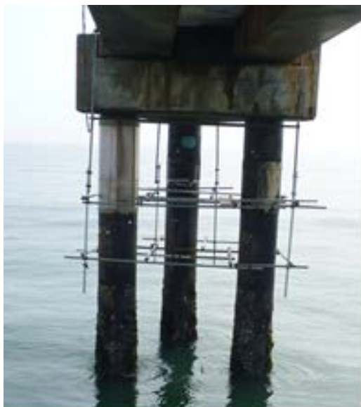
写真-5.1 外観写真 (杭 No.33,34,35)
