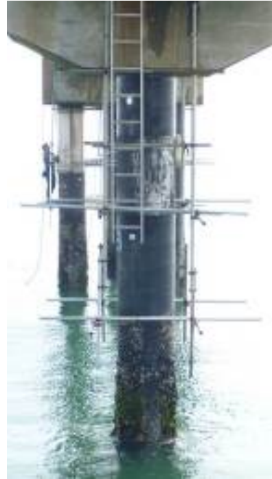
写真-5.2 外観写真 (杭 No.32)
