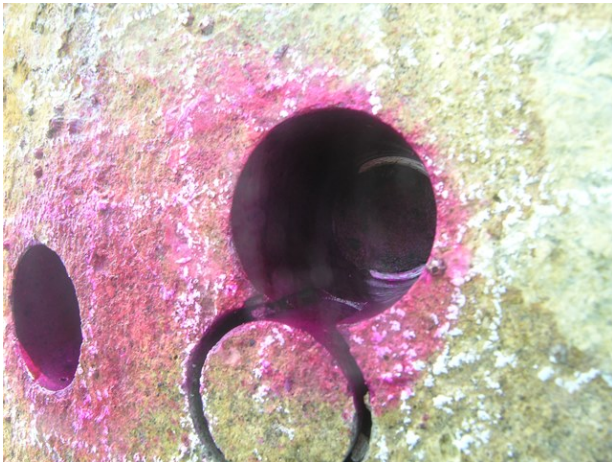
写真-7.18 コア採取孔内部の鋼材(鋼管杭)の腐食状況(+2.0m付近)
