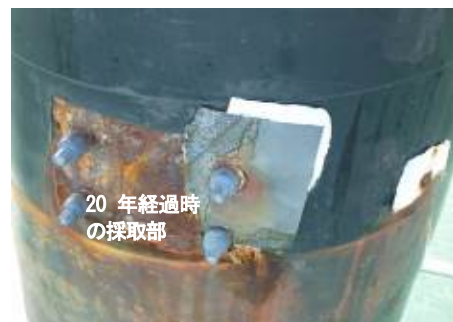
写真-5.14 No.31杭の20年経過時の調査のサンプル採取部に施した部分補修の破損状況
