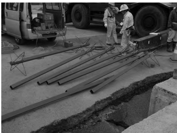
写真-1.1 挿入型傾斜計用ガイド管
