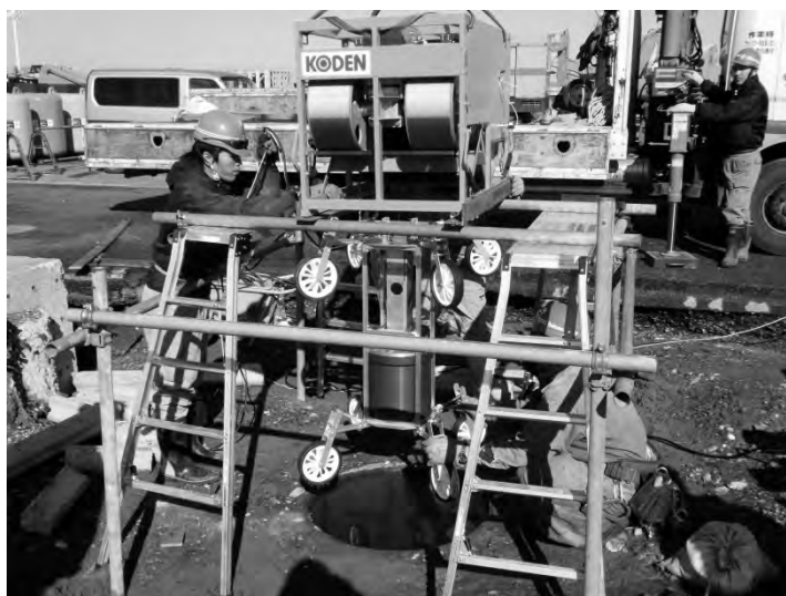
計測台車を取り付けた超音波式側壁測定装置の設置状況
